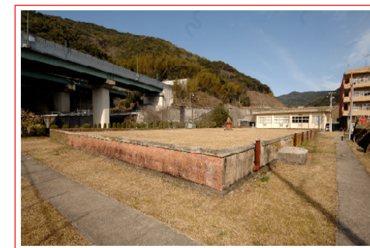
④【高部配水池】
