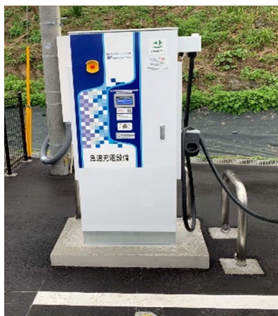
【急速充電設備】
