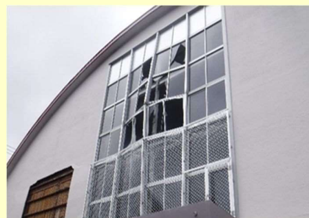
写真：令和2年9月台風第10号による被害（長崎市）
