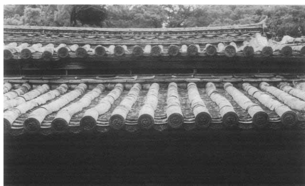
【瓦ずれを起こした屋根】
