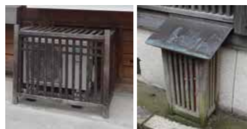
設備の目隠し
