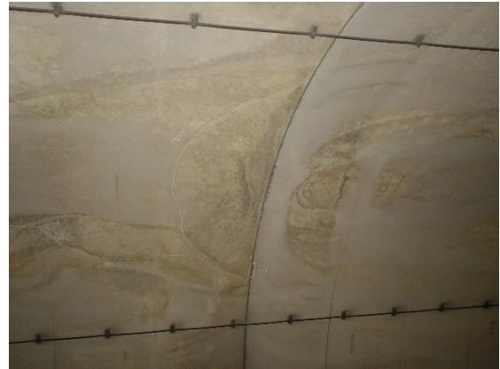
覆工コンクリートの目地沿いのひび割れ (運動公園トンネル)
