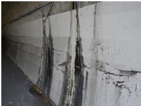
覆工コンクリート打ち継ぎ目からの漏水 (長崎卸トンネル)
