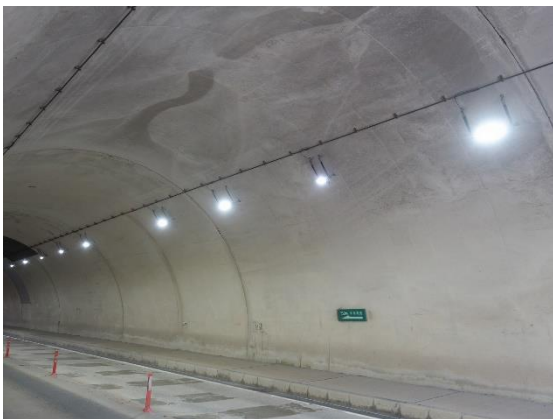
照 明（LED 照明器具）
