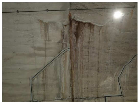
覆工コンクリートのひび割れ沿いの漏水 (矢上団地トンネル)
