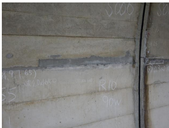
覆工コンクリート打ち継ぎ目のうき (矢上団地トンネル)
