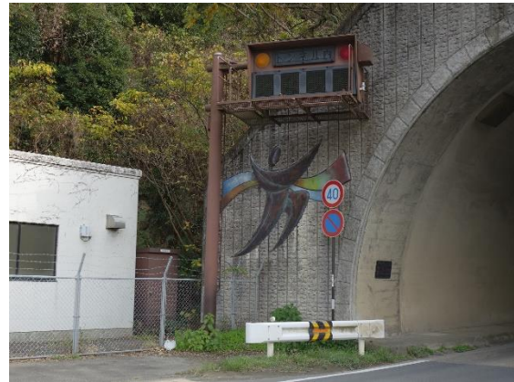
非常用施設：警報表示版 （運動公園トンネル）
