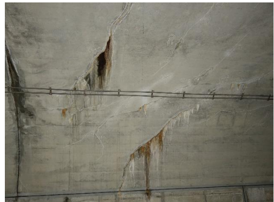
覆工コンクリートアーチ部のひび割れ (牧園トンネル)
