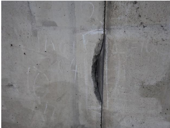
覆工コンクリート目地部のはく落跡 (運動公園トンネル)
