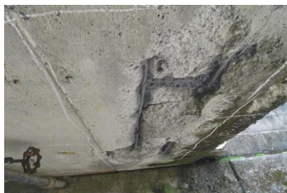
橋梁損傷状況
