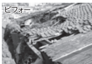
長年放置されて老朽化した空き家も...
