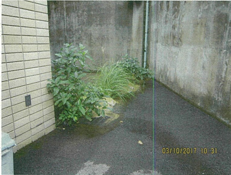
②庁舎側面の出水
