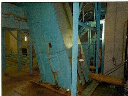
既設除塵設備
