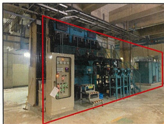
水処理脱臭設備
