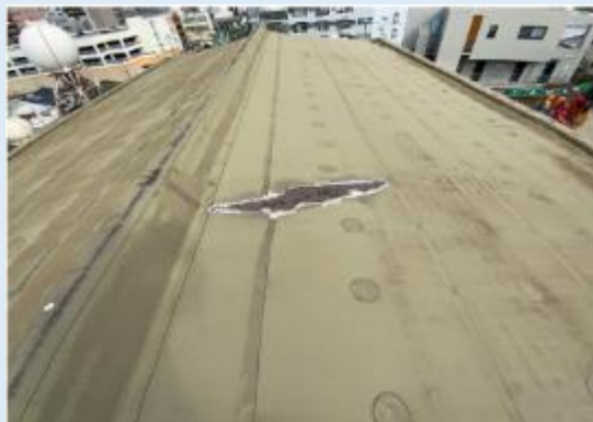
屋上防水(破断)
