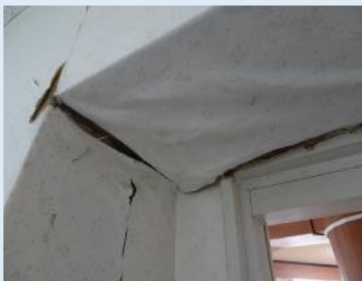
トイレ天井(雨漏り、剥離)
