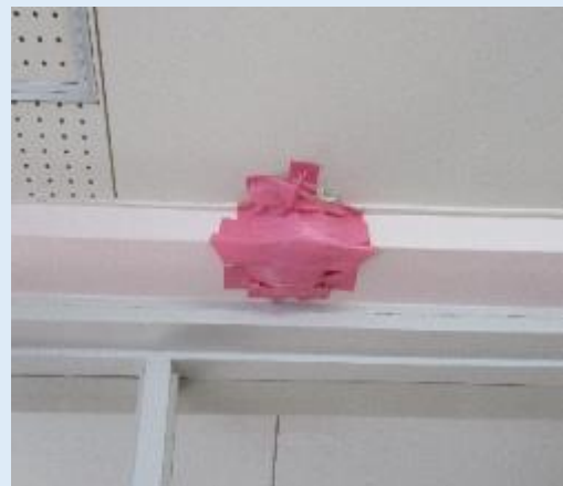
保育室の天井(雨漏り)
