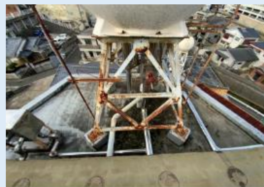
屋上水槽基礎(発錆)
