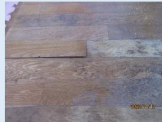
保育室床(剥離)
