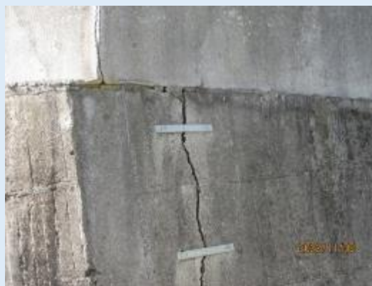
園庭側外壁(ひび割れ・劣化)
