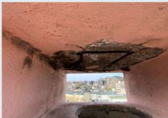
煙突躯体(爆裂)
