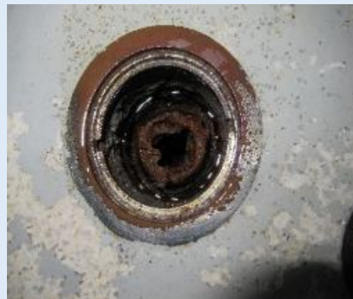
水道管(錆、詰まり)
