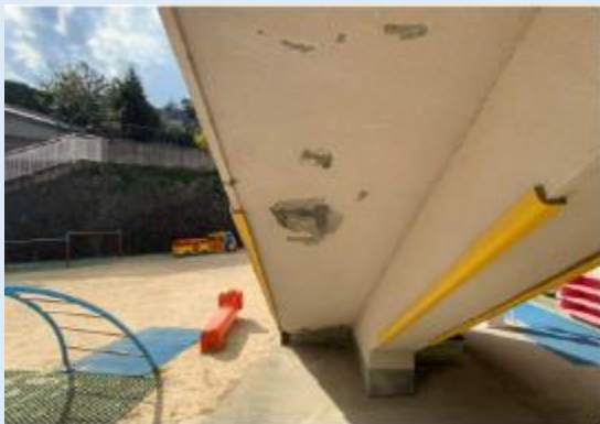
屋外階段裏(爆裂)
