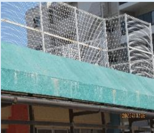
屋根部(剥離・劣化)
