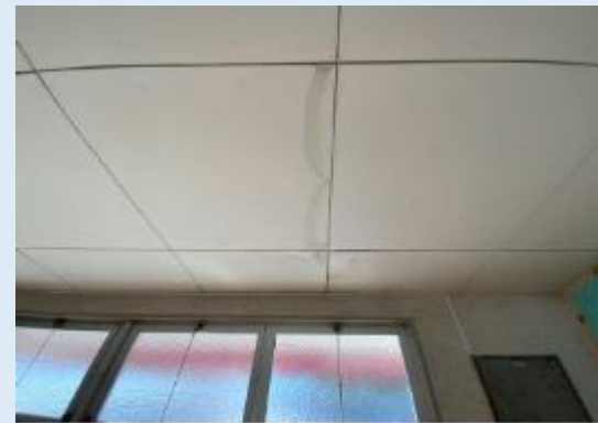
屋内天井(漏水跡)
