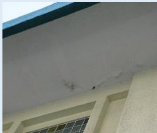
軒裏(亀裂・塗装剥離)
