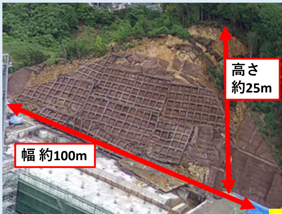
ア 法面崩落直後（令和6年6月10日時点）
