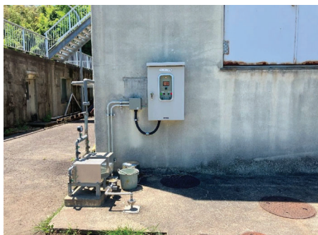
写真 8-14 ポンプ操作盤
