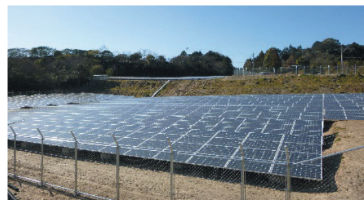
【太陽光発電設備】
