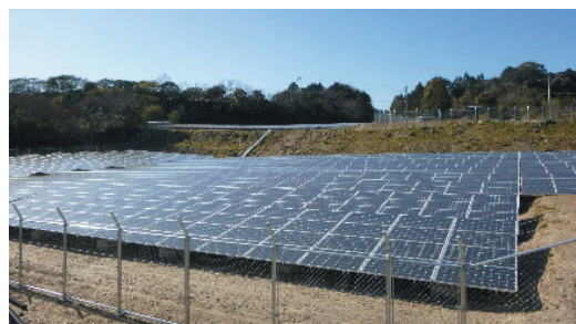
【太陽光発電設備】
