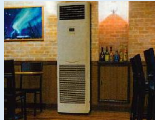
整備予定空調設備(床置型)
