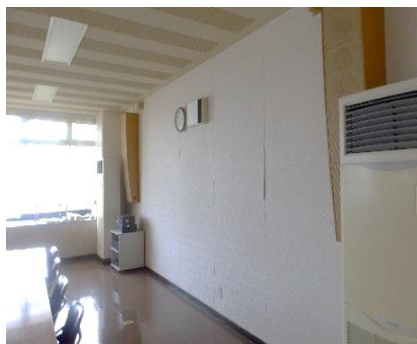
壁面クロス剥がれ
