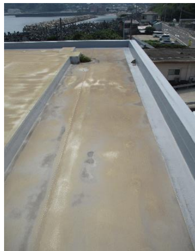
屋上防水シート亀裂
