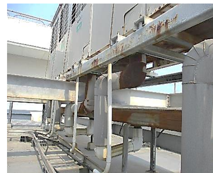
空調冷媒管腐食
