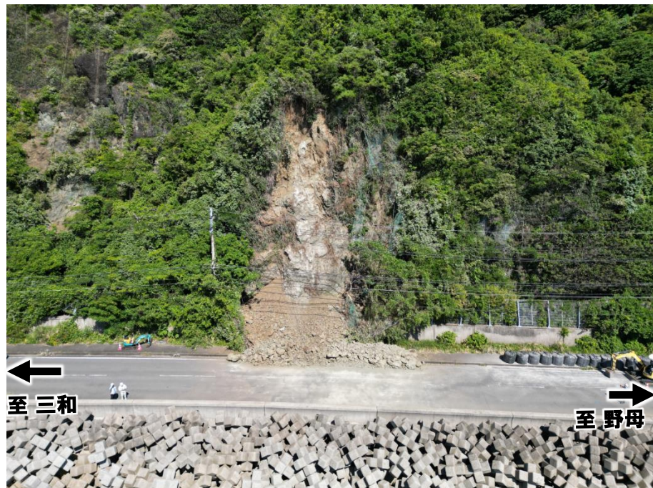
被災状況 5月11日時点
