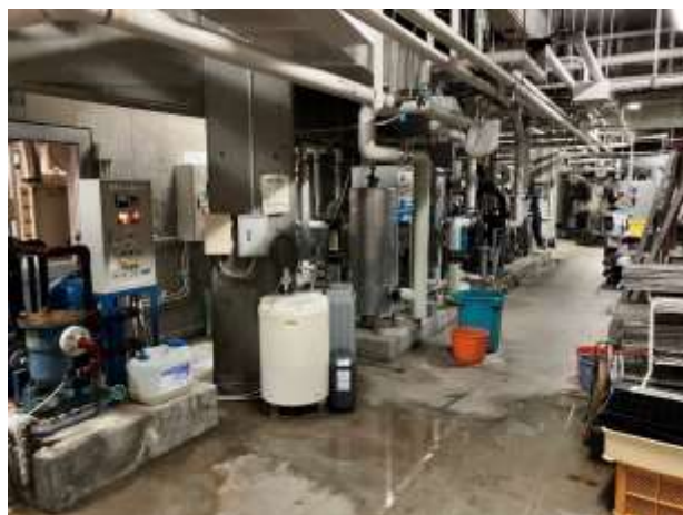
大浴場下機械室
